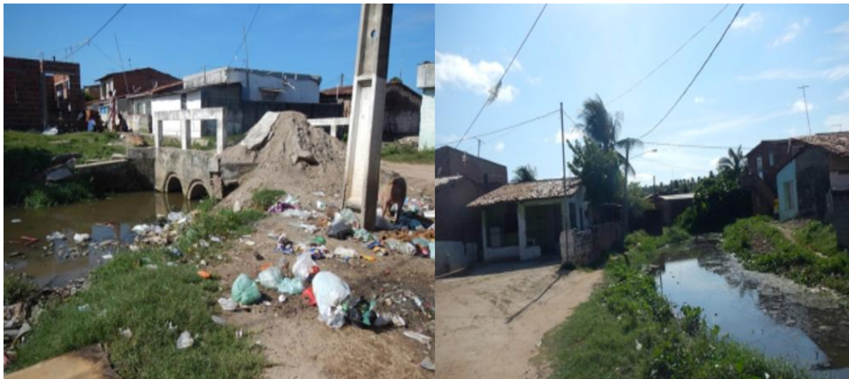
Figura 7 - Setor Rua da Biquinha do Bairro Pilar, região com risco alto à inundação.
