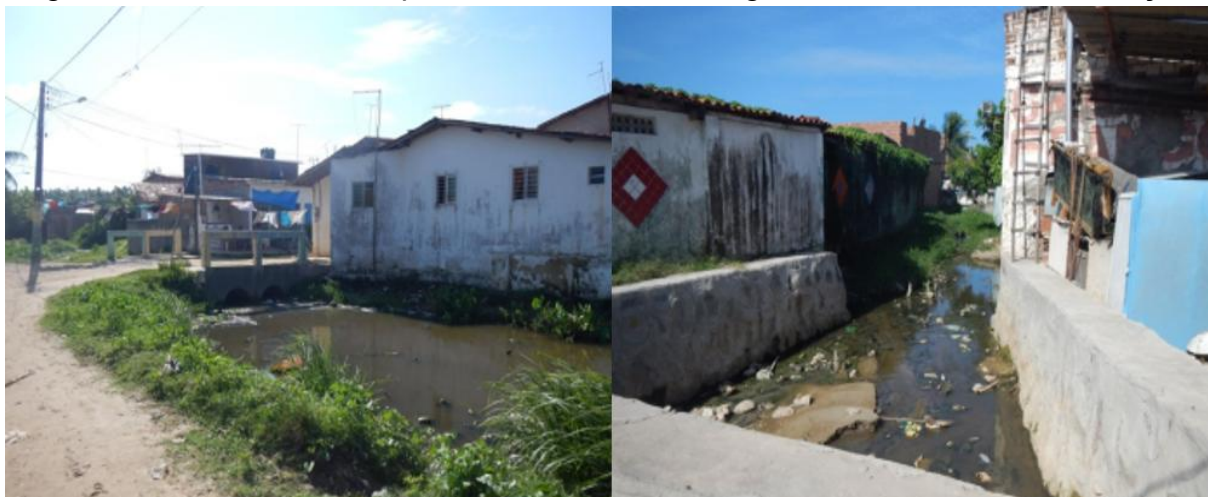
Figura 8 - Setor Rua da Biquinha do Bairro Pilar, região com risco alto à inundação.
