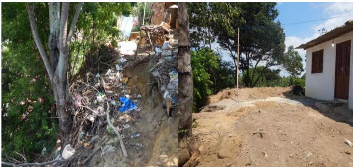
Figura 6 - Setor Alto do Pôr do Sol, região com risco alto ao deslizamento.
